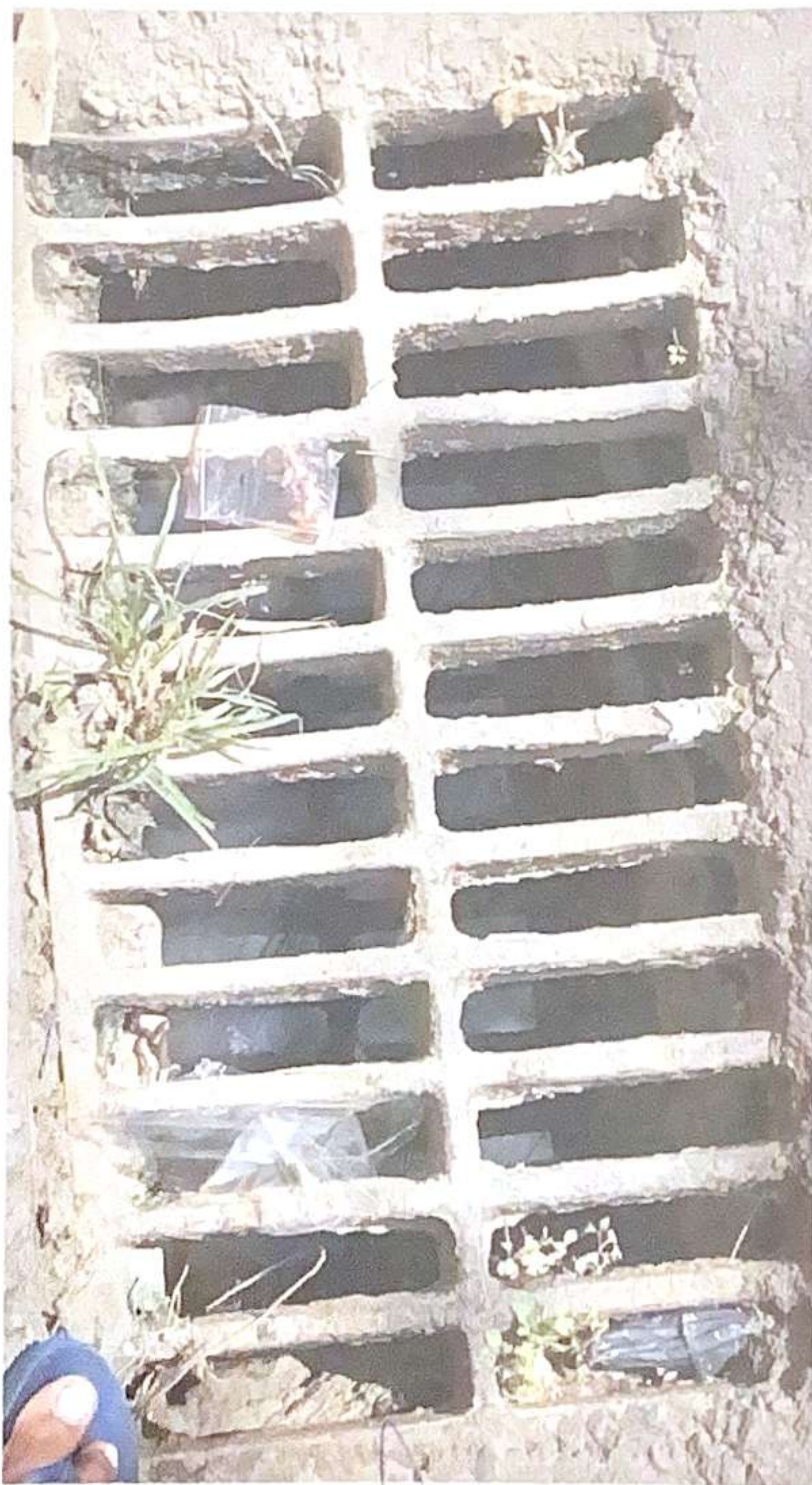
FOTO 3: BUEIRO ENTUPIDO E COM ÁGUA PARADA
